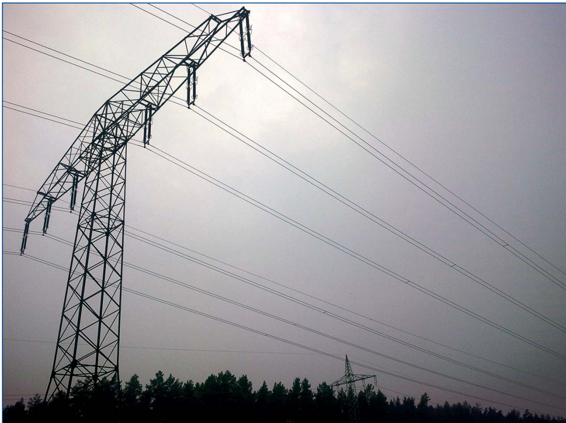
Abb. 3.18: Typische 220-kV-Freileitung | Foto: Gerhard Hofmann, Agentur Zukunft
