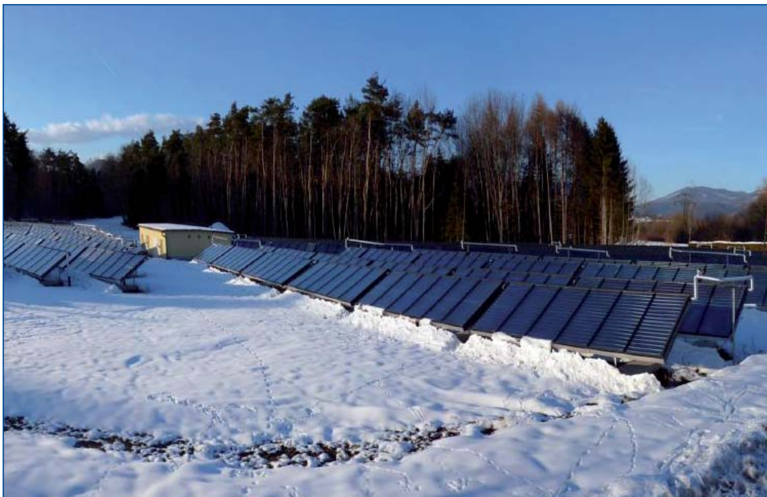
Abb. 3.2: Solarthermische Freiflächenanlage | Foto: www.solid.at
