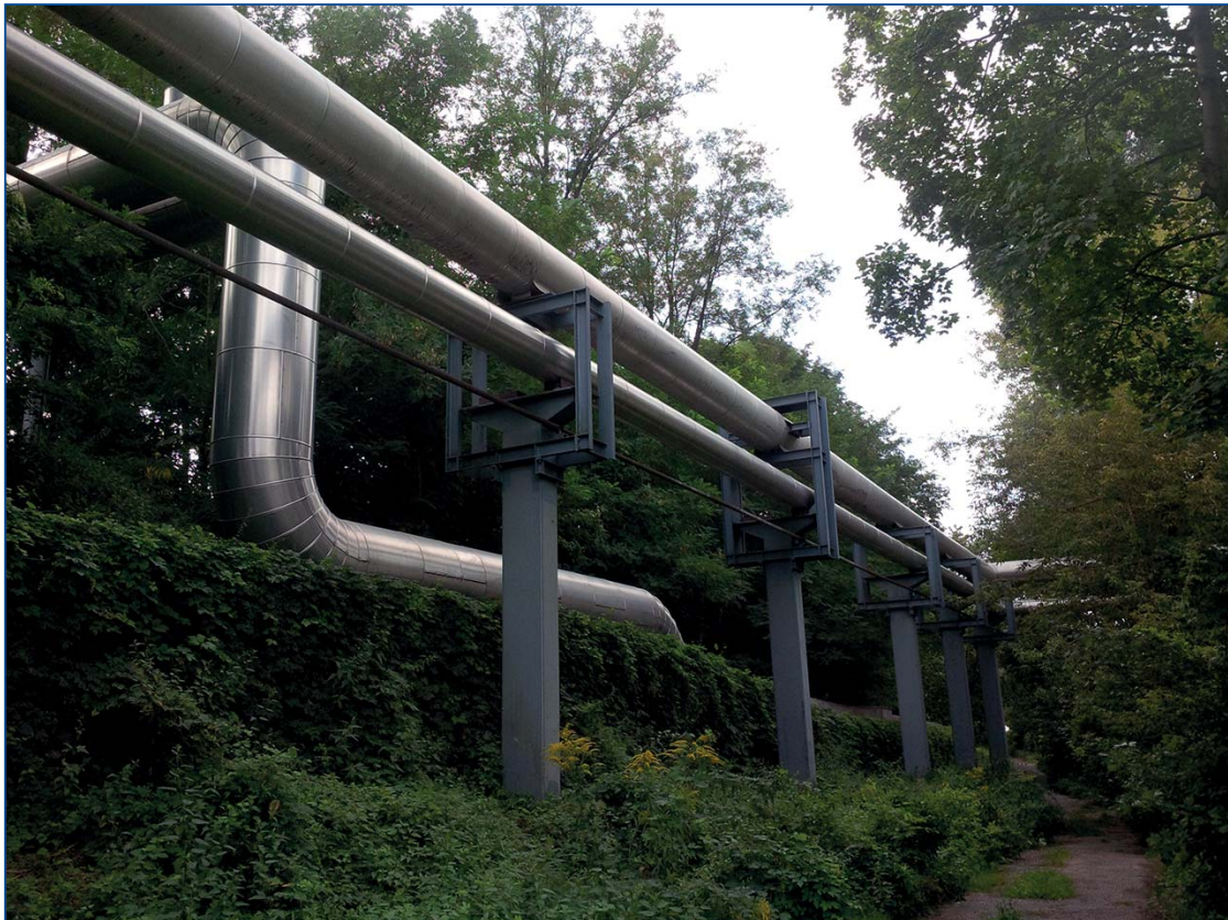
Abb. 3.20: Leitungen eines Fernwärmenetzes | Foto: Gerhard Hofmann, Agentur Zukunft
